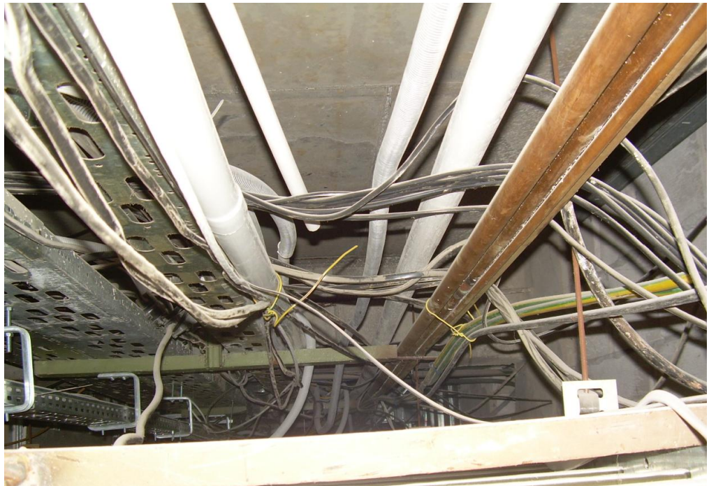
Rys. Widok instalacji nad sufitem podwieszanym w ciągu komunikacyjnym NP, bud. B
