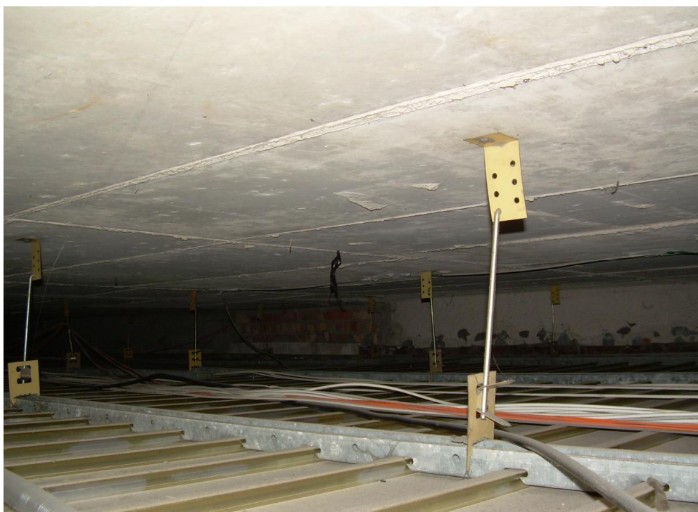
Rys. Widok instalacji nad sufitem podwieszanym w ciągu komunikacyjnym NP, bud. A
