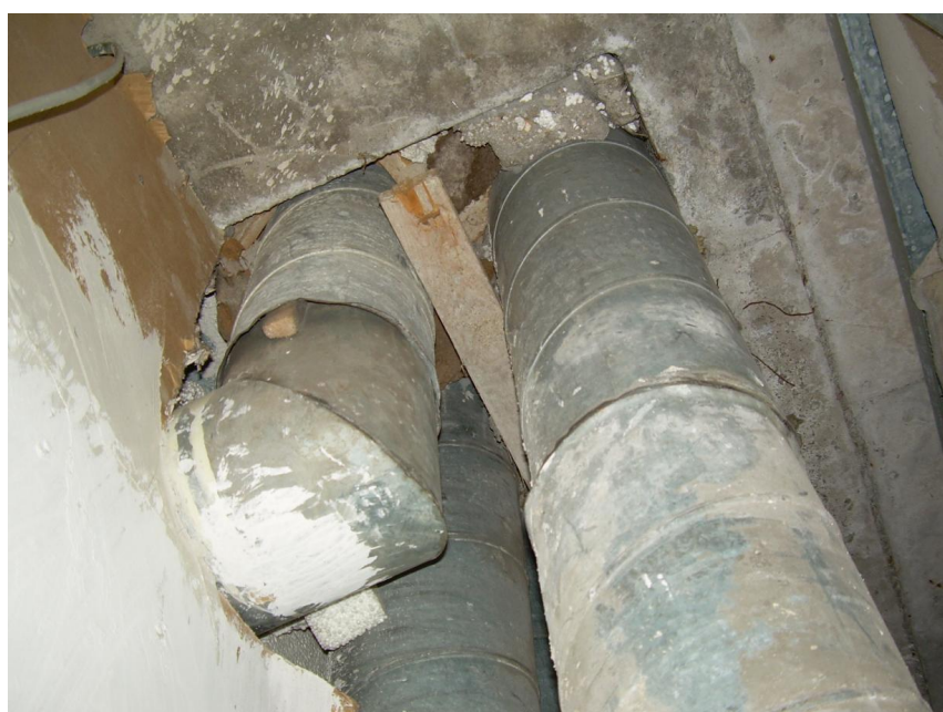
Rys. Widok instalacji w szachcie
